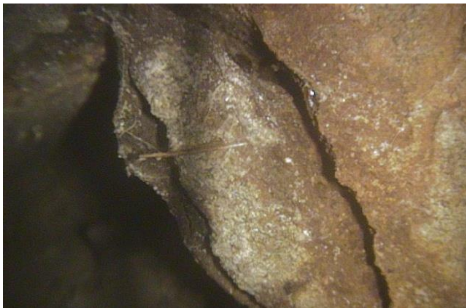
Obr. 13.15.: Detail poškození okraje pásoviny podélnou svislou trhlinou způsobenou korozí oceli. Skutečnou míru poškození však lze jen odhadovat.
