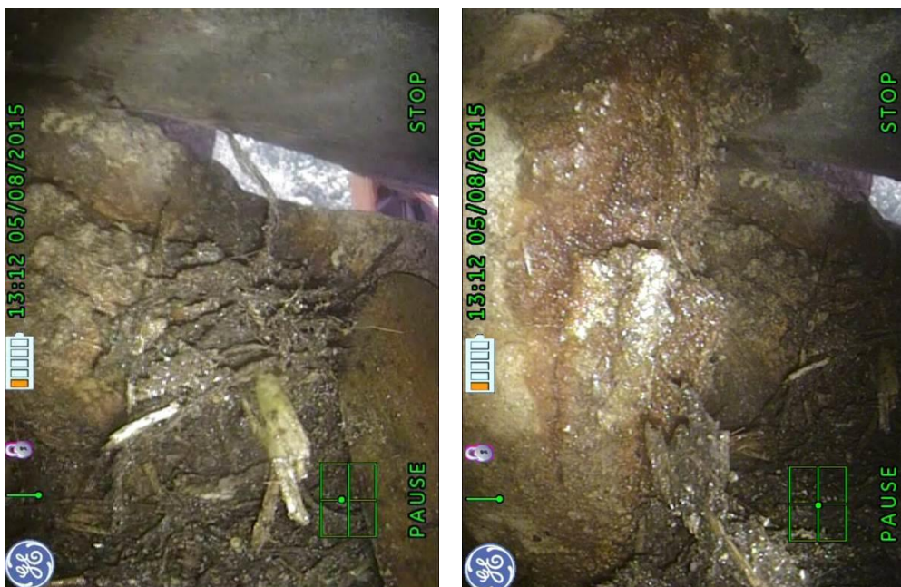
Obr. 13.14.: Pohled videoskopem do nezainjektované kapsy v soklu vyplněné biologickým materiálem, vpravo zkorodovaný povrch výztuhy procházející ze soklu do horního disku.
