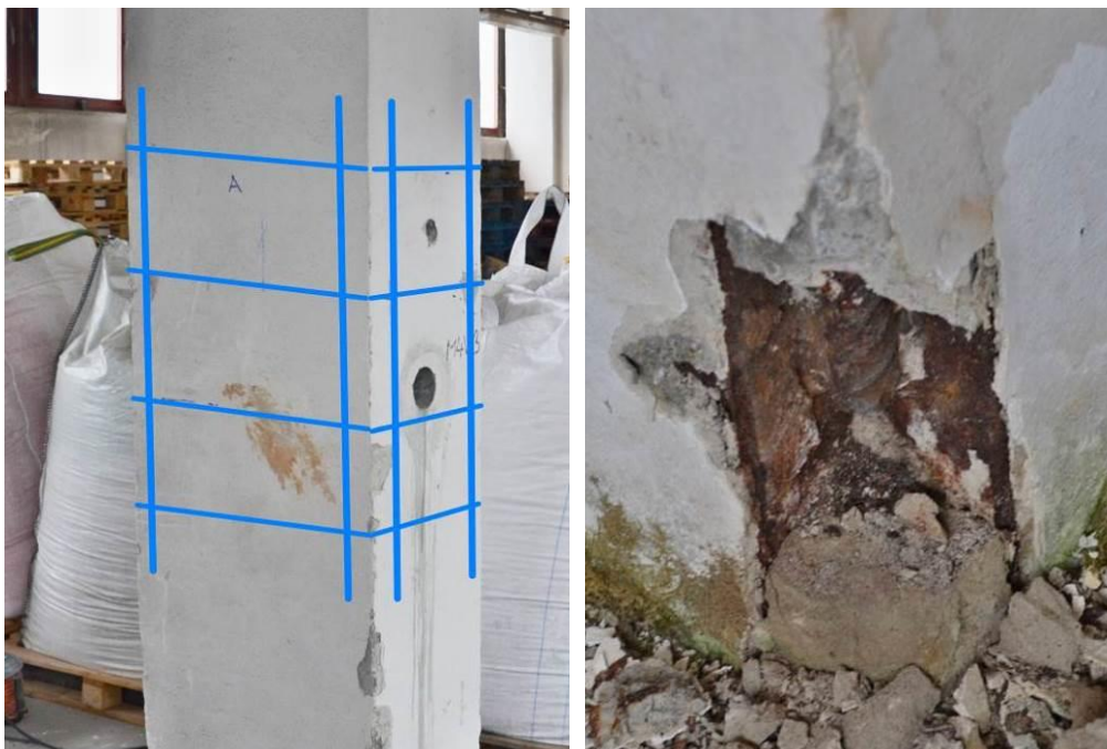
Obr. 7.17.: Sloup obdélníkového průřezu s vyznačenou hlavní výztuží (4 pruty v rozích) a třmínky se vzdáleností od sebe > 200 mm; vpravo kontrola průměru v místě odpadnuté krycí vrstvy – výztuž \varnothing 28 mm přivařená k úhelníku.
